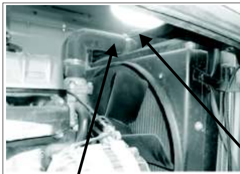
Mangueras de refrigeración revisar 250 horas (f)
